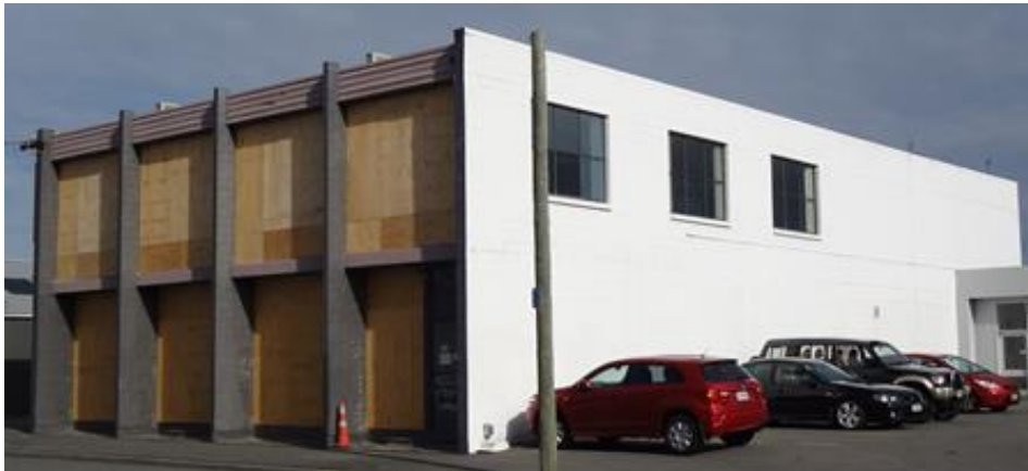
तस्वीर 1. भूकंप से प्रभावित एक मकान। सफेद रंग की ईंट की दीवारों के कारण क्षति कम हुई है। इस दीवार के समकोण की दिशा में एक लचीली संरचना प्रणाली है, जिसमें काफी विक्षेपण (deformation) की वजह से फसाड (façade) टूट गए हैं, और इन्हें प्लाईवुड (plywood) से ढका गया है।
